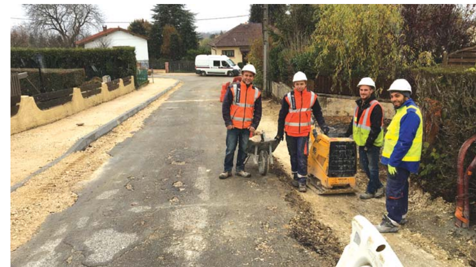
Les employés s'affairent pour terminer les travaux en cours avant le début de l'hiver.
